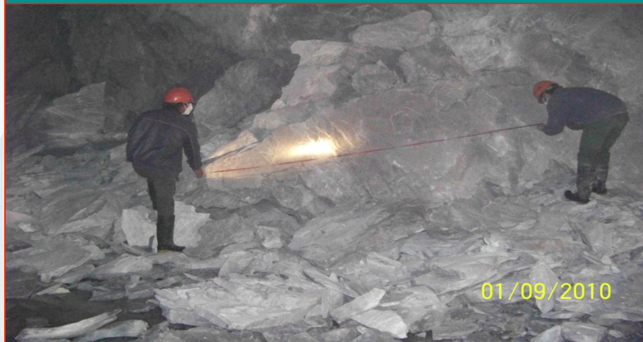
开挖过程中遇到强岩爆
